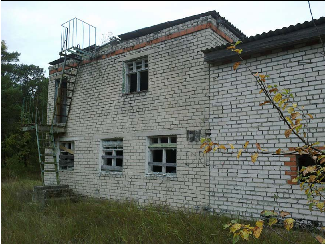
Foto 3. Lehtma tehnilise vaatluse post. Katusel olnud putkad on lammutatud, eterniitkatuse paigaldas EV piirivalve 1990. aastate algul. Foto Ain Tähiste 17.10.2013.
